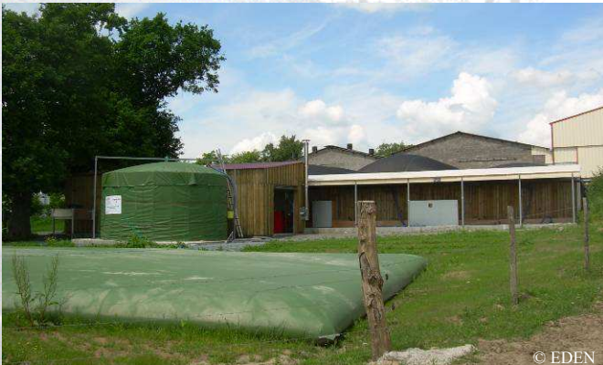
Vue sur la partie technique de l'unité de méthanisation
