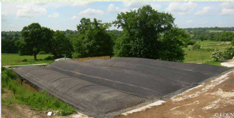
Vue sur les digesteurs et leur couverture EPDM
