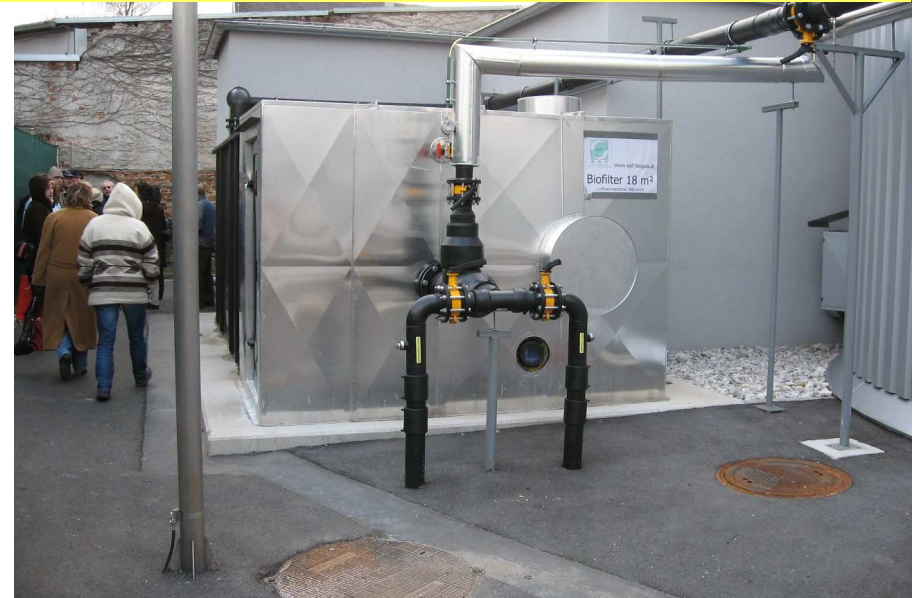
Désulfuration par biofiltre
