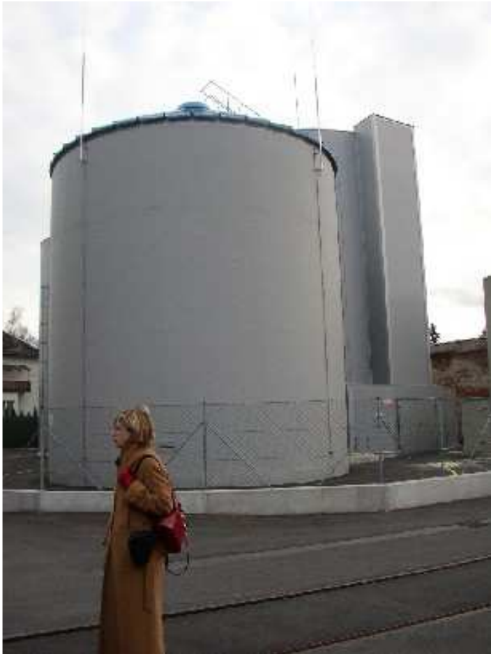
Réservoir à biogaz de 450 m 3 soit 1 à 2 h de production
