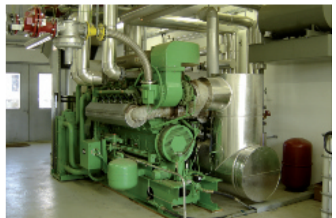
Cogénération du biogaz en Autriche - RAEE
